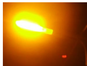
Lampadaire à vapeur de sodium-1950, efficace en cas de brouillard
